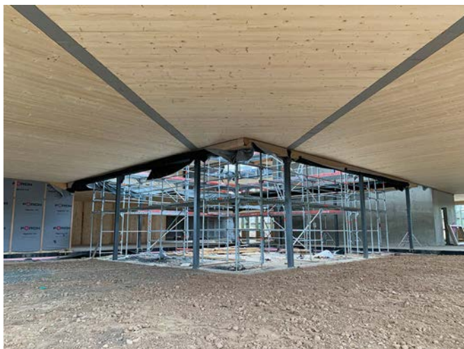
Bild 9 Rathaus Hainburg, diagonale Unterzüge in Decke über EG (Quelle: B + G) Hainburg town hall, diagonal beams in slab above ground floor
