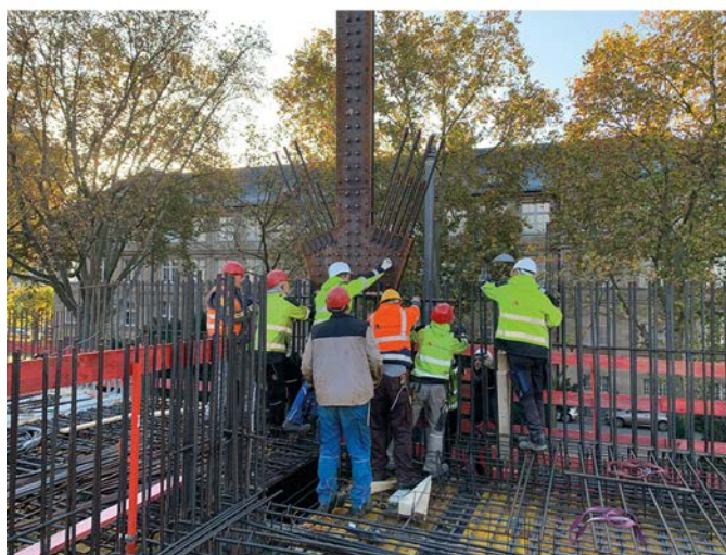
Bild 7 Stahlbauteil 1 im Modell (oben), in der Ausführung (unten) (Quelle: B + G) Steel mounting part 1 in model (top), during the construction (bottom)
